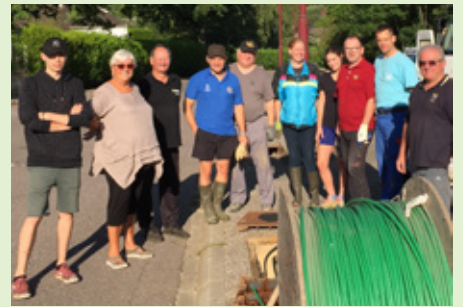
Par souci d'économie, le conseil municipal a déployé, lui-même, 800 mètres de fibre dans les réseaux souterrains, pour relier les deux caméras au poste de contrôle, avec l'aide bénévole de quelques habitants.
